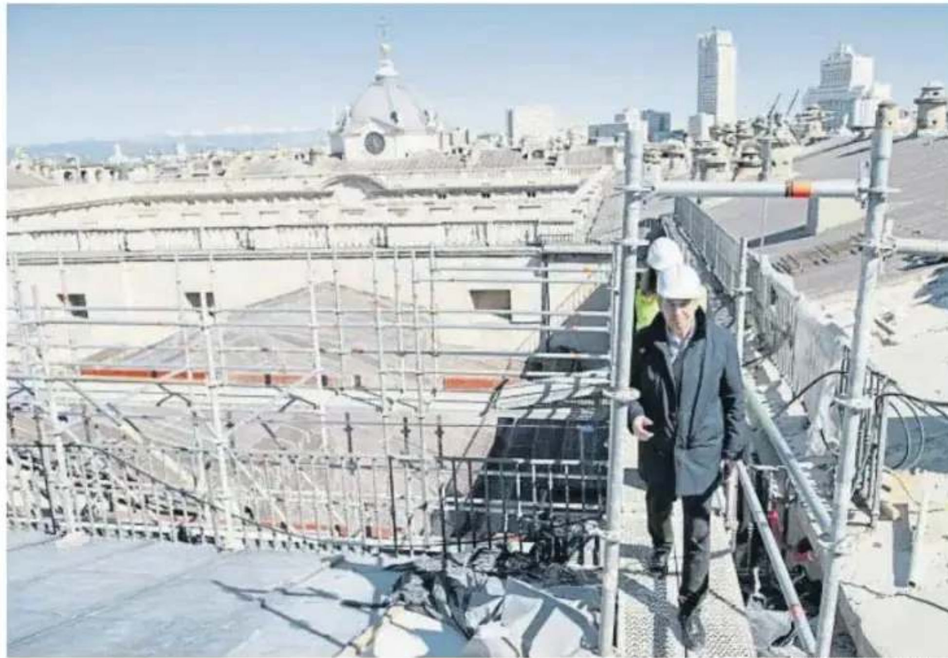
El arquitecto Luis Pérez de Prada durante la visita de obras a la cubierta del Palacio Real
